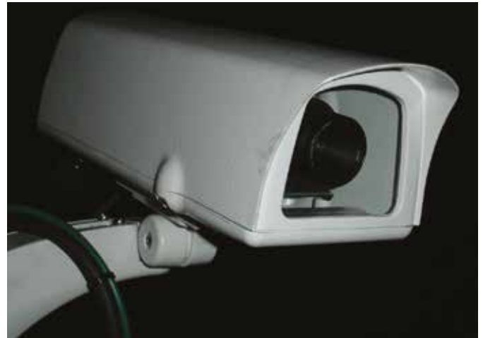
Exemple de caméra installée en tunnel.
