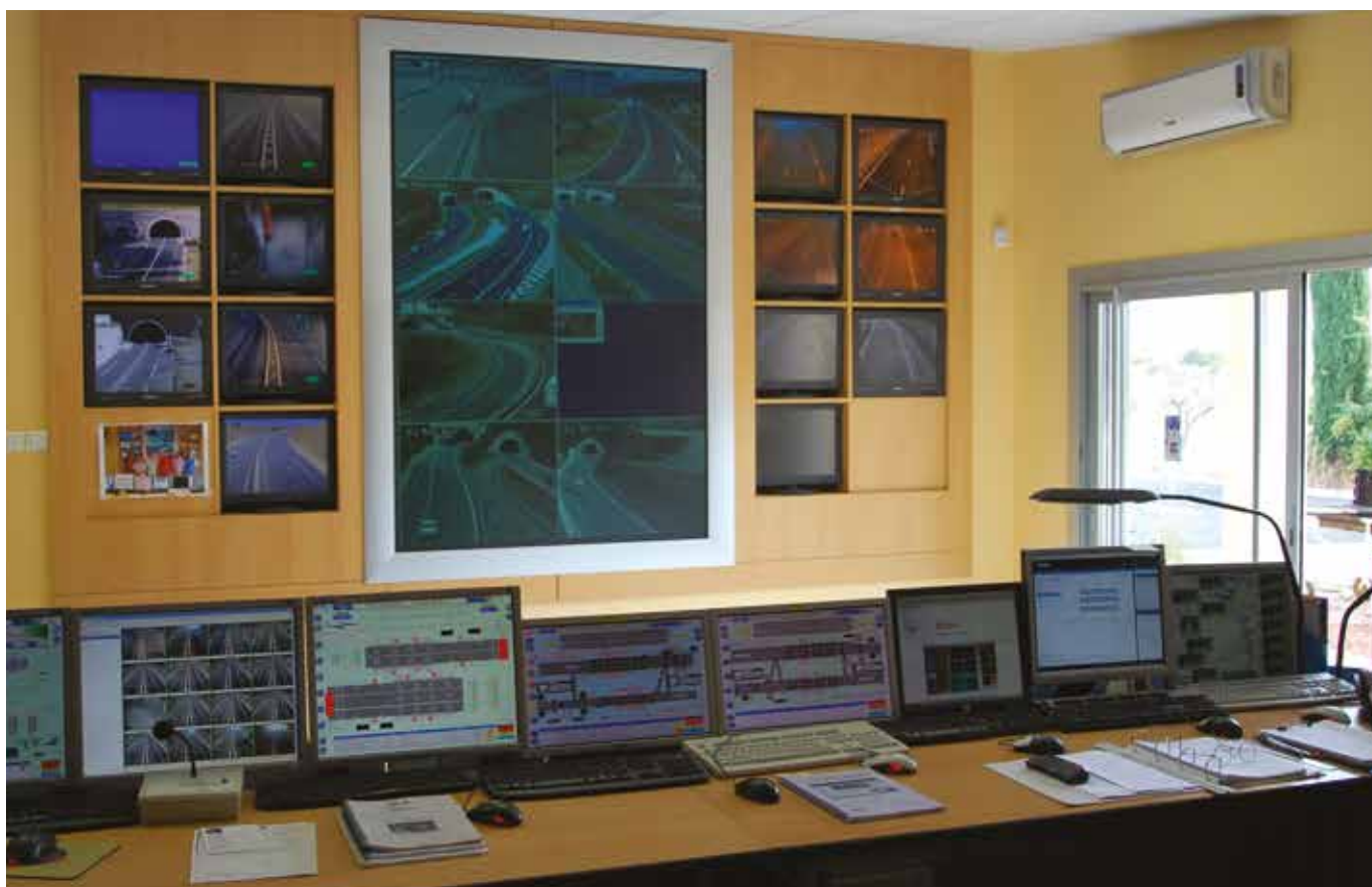
Mur d'images du Poste de Contrôle Commande du Centre d'Ingénierie et de Gestion du Trafic de Clermont l'Hérault.
