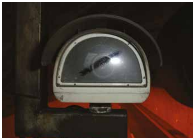
Exemple d'encrassement de la vitre du caisson d'une caméra.
