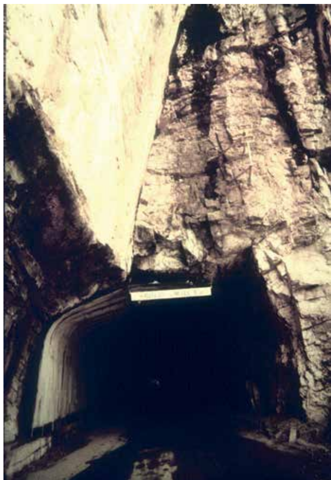
Figure 14a : état lors de la première inspection
