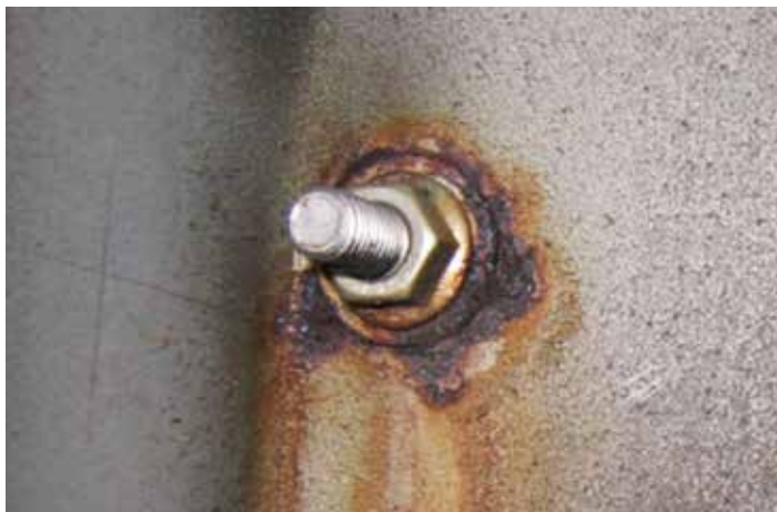
Figure 1. Forte suspicion de corrosion caverneuse dans un assemblage boulonné
