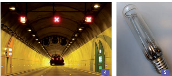
Photo 4 : lampes à vapeur de sodium haute pression équipant le tunnel des Monts
