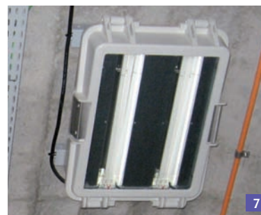
Photo 6 : tubes fluorescents équipant le tunnel du Lioran
