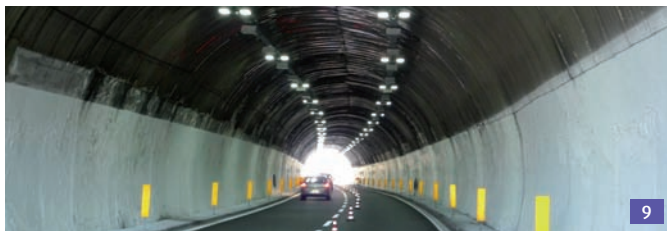
Photo 9 : tunnel Diano Calderina, tube sens Italie France équipé de LED
