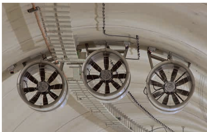
Exemple de moyen non compensable : système de ventilation de désenfumage
