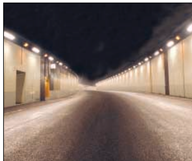
▲ Photo n° 3 - Tunnel de Nogent sur A86 dans le Val de Marne (section courante)
