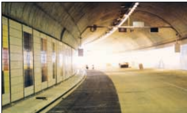
▲ Photo n° 13 - Voies de circulation claires et bande d'arrêt d'urgence sombre (la bande d'arrêt sombre est à déconseiller en tunnel)
