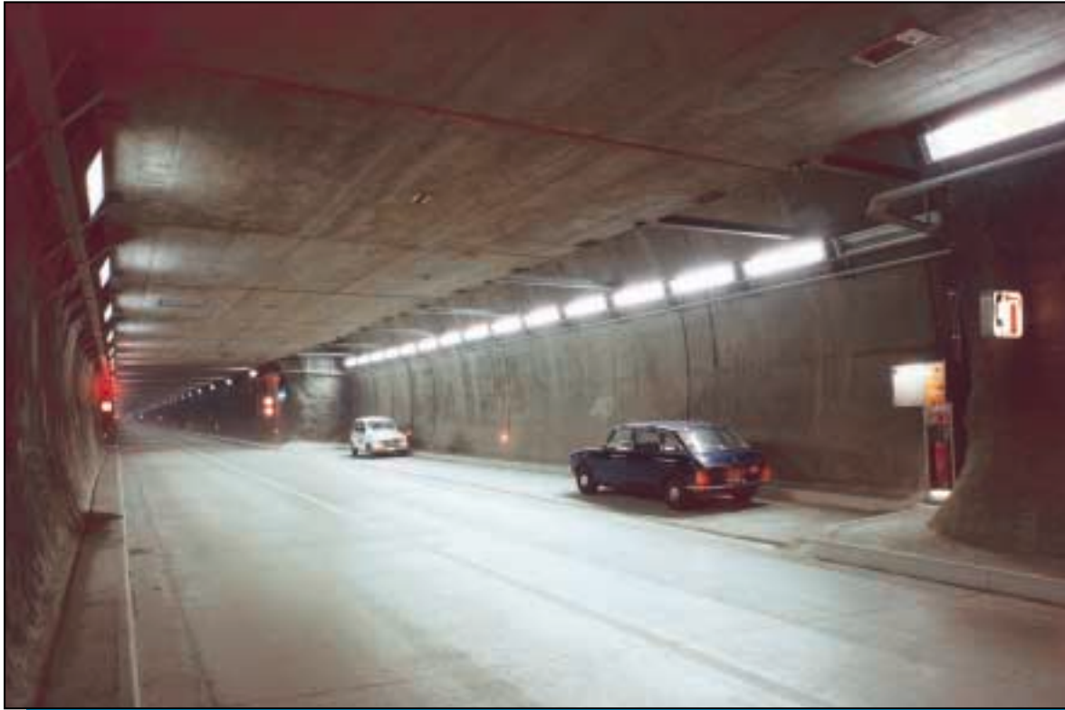
▲ Photo n° 6 - Eclairage d'un garage dans le tunnel Maurice Lemaire (Sainte Marie aux Mines - RN 159 - Vosges)
