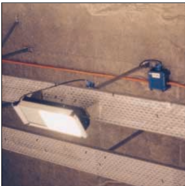
▲ Photo n°24 - Circuit d'éclairage secouru fixé en voûte pour être indépendant des chemins de câbles dans le tunnel de la Grand-Mare à Rouen (RN 28 Seine Maritime)
