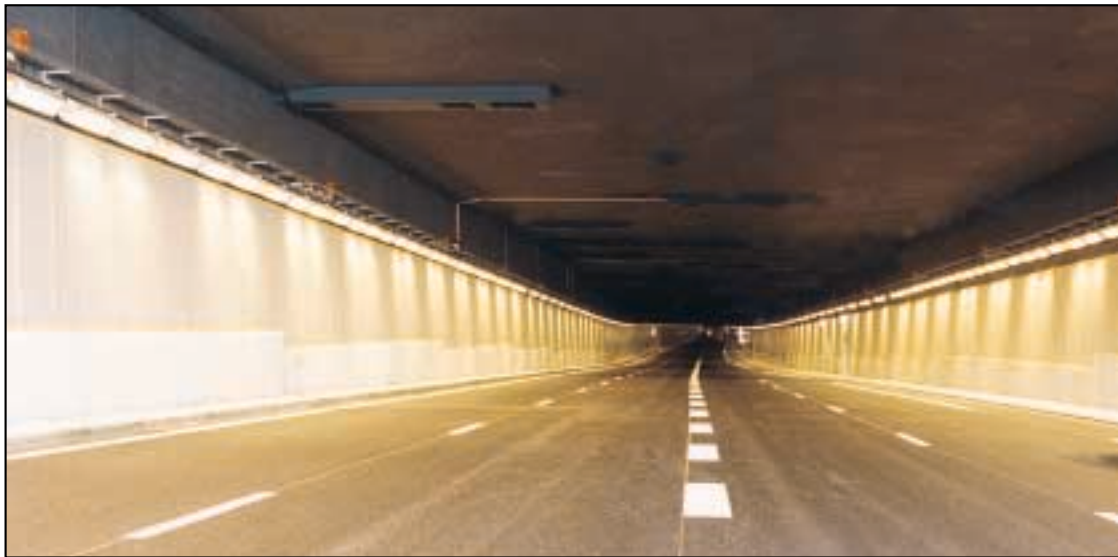
▲ Photo n°21 - Installation bilatérale dans la tranchée couverte de Bobigny (autoroute A 86 - Seine Saint-Denis)
