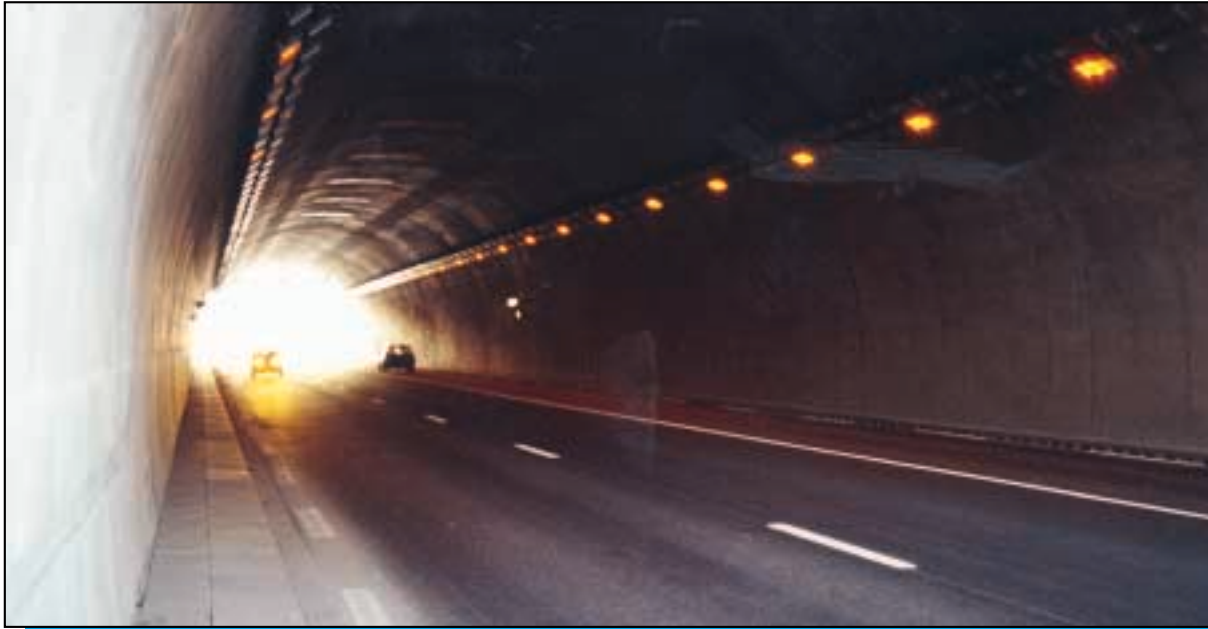
▲ Photo n° 4 - Tunnel de Cornil (RN 89 - Corrèze) L'éclairage de renforcement d'entrée d'un sens joue le rôle de renforcement de sortie pour l'autre sens
