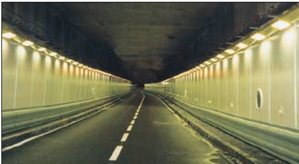
▲ Photo n° 15 - Appareils symétriques à tubes fluorescents dans le tunnel de Dame-Joliette (Marseille)
