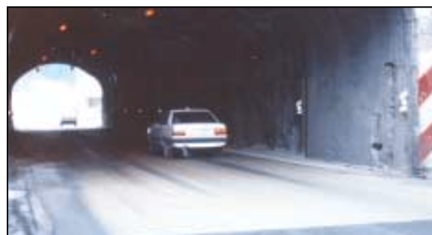
▲ Photo n°14 - Chaussée claire dans le tunnel du Chatelard (RN 205 - Haute-Savoie) La chaussée claire aurait dû commencer une dizaine de mètres après l'entrée
