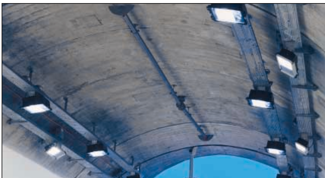
▲ Photo n°23 - Renforcement à contre-flux et éclairage de base symétrique dans le tunnel de la Grand-Mare à Rouen (RN 28 - Seine Maritime)
