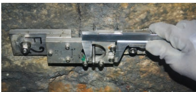
Exemple de prise de mesure avec un fissuromètre
