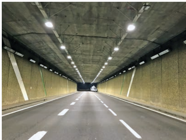
Nouvelle installation LED en voûte avant dépose de l'ancienne installation latérale en SHP
