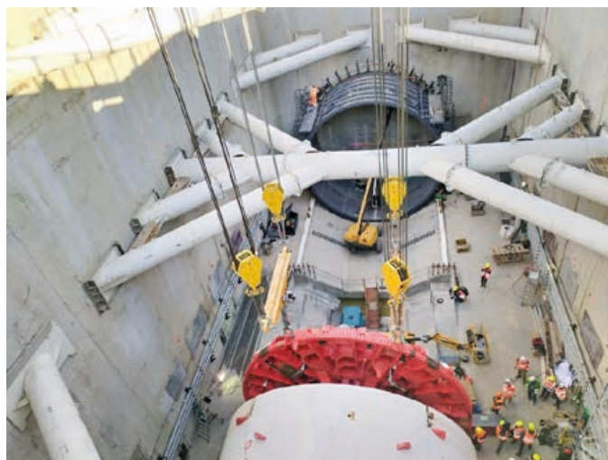
Mise en place du tunnelier pour le prolongement de la ligne B Sytral
