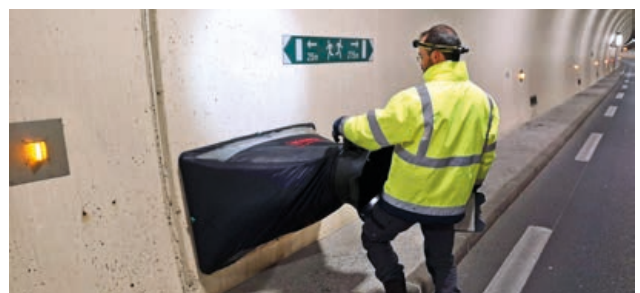
Mesures de ventilation : IDP du tunnel du Lioran
