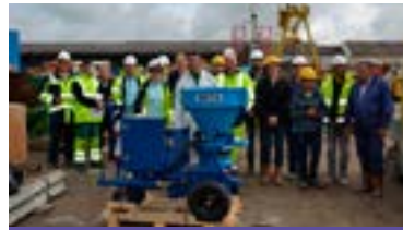
Première journée de démonstration des bonnes pratiques de la projection du béton
