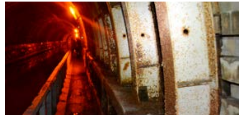
Zone cintrée avec vue sur la passerelle sur laquelle criculent les vélos qui accompagnent les bateaux
