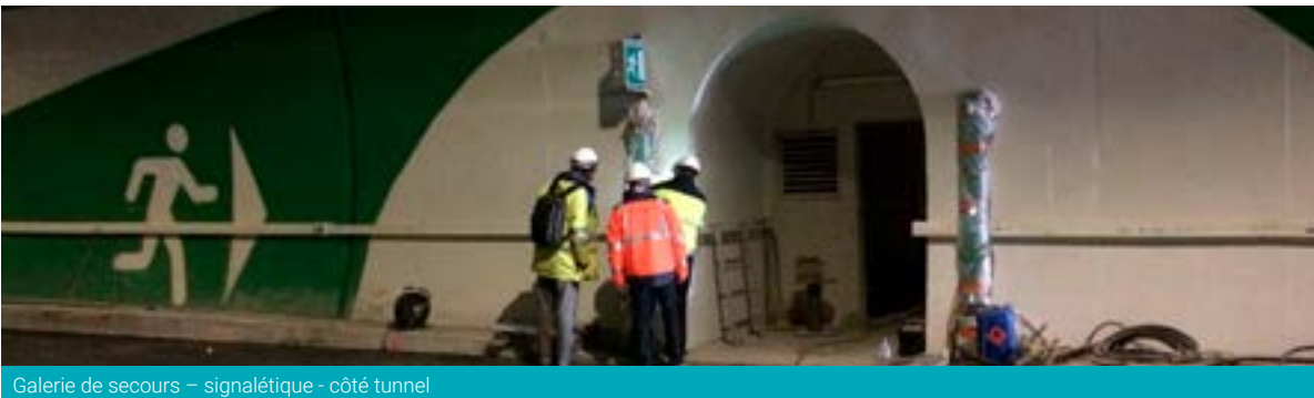
Galerie de secours – signalétique - côté tunnel
