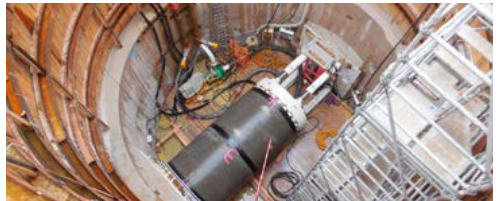
Le microtunnelier du projet Aéroports de Paris à Roissy avant et après sa mise en place dans le puits de départ.
