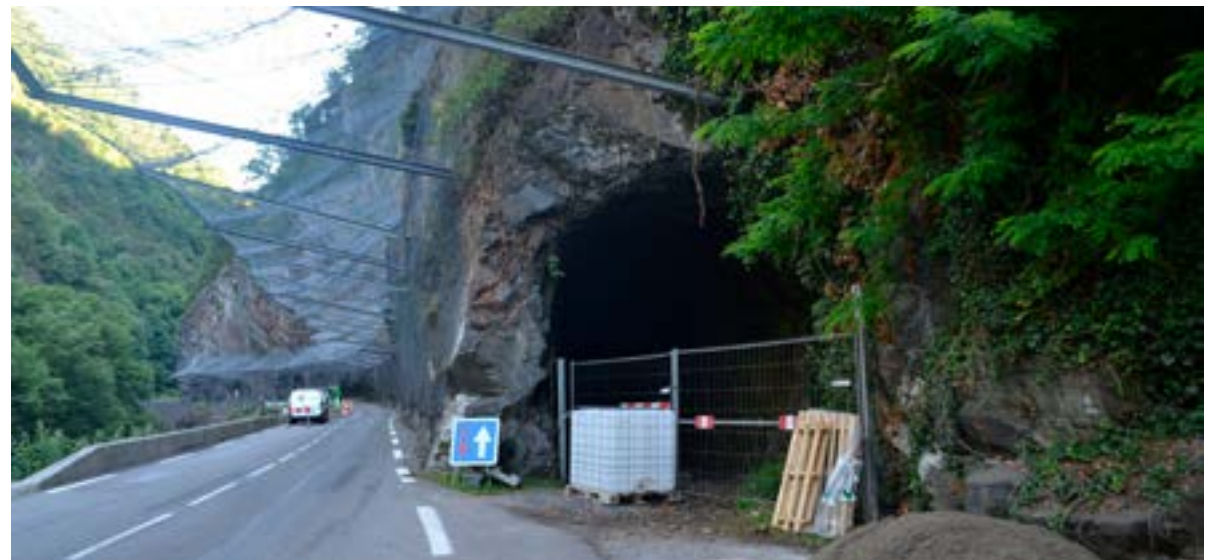
Tunnel d'Arriou-Cluc (Tête sud) et réparation des protections contre les chutes de blocs au-dessus de la RD921
