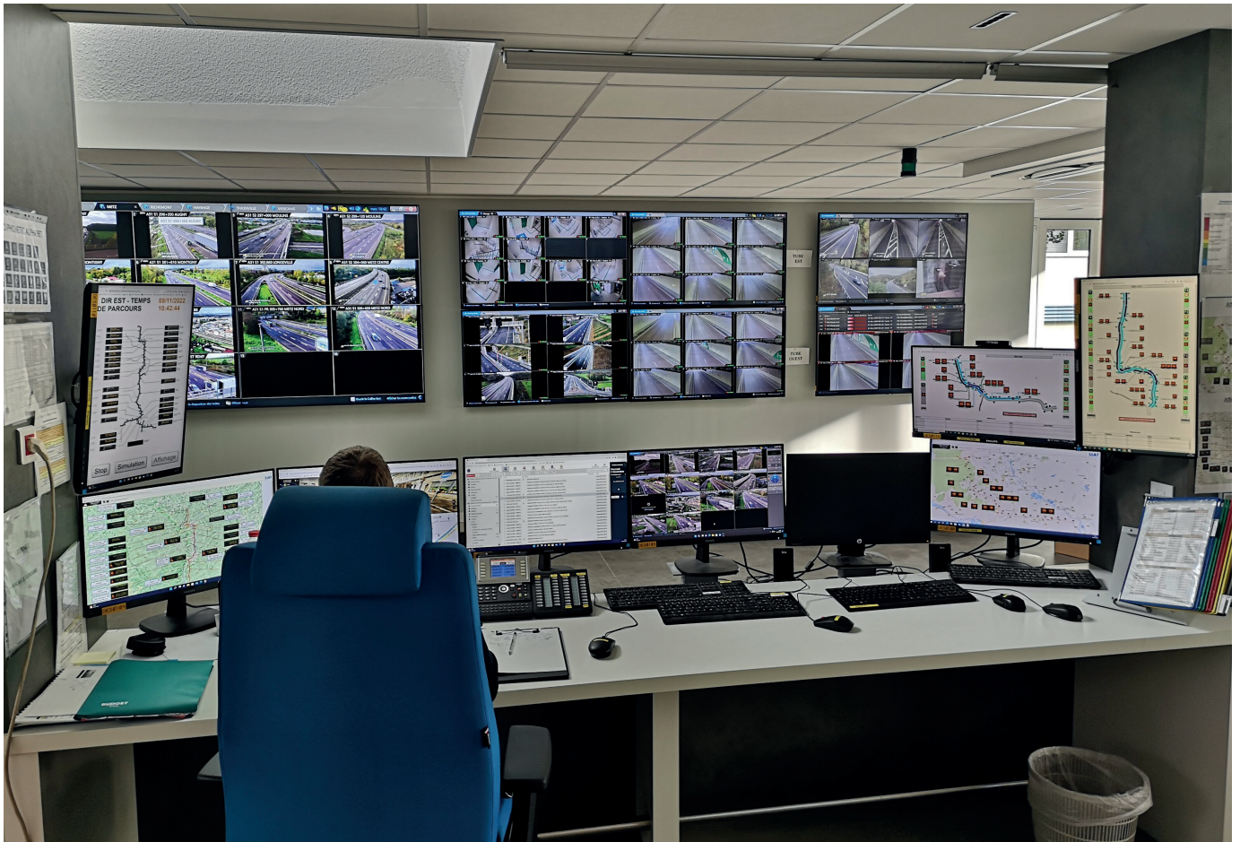
Figure 1 : Mur d'images du Poste de Contrôle Commande du Centre d'Ingénierie de Sécurité et de Gestion du Trafic de Moulin-les-Metz
