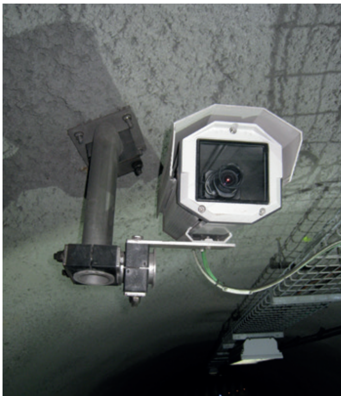
Tunnel des Montets – Caméra de vidéosurveillance (© CETU)
