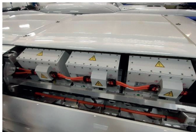
Figure 15 : Batteries sur un bus électrique
