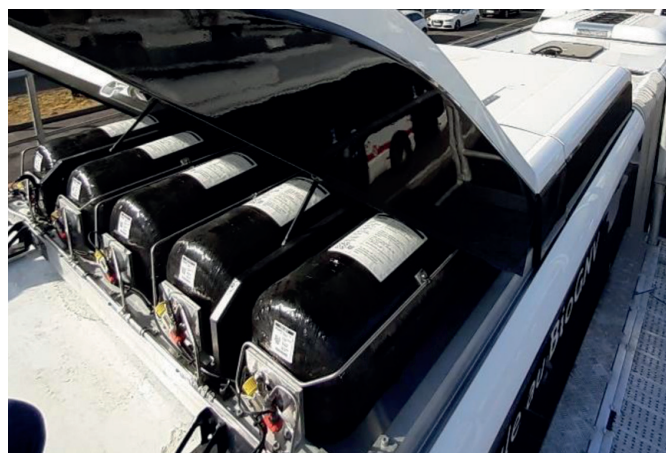
Figure 16 : Réservoirs GNC sur un bus
