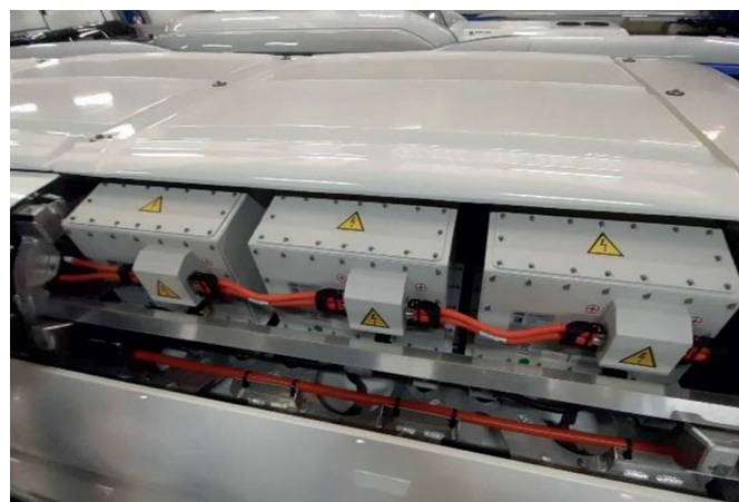
Figure 15 : Batteries sur un bus électrique
