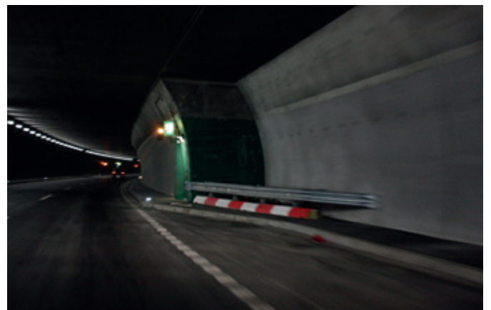
Tunnel de Sierre après l'accident de 2012 – Source : CETU
