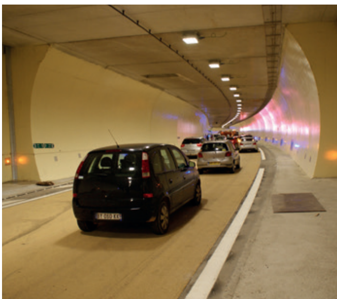
Tunnel de Toulon avant traitement – Source : CETU
