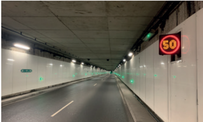
Illustration 24 : Panneau lumineux pour limitation de vitesse dans un tunnel (crédit photo : CETU)
