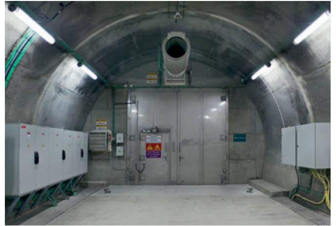
Illustration 8 : Ventilation d'une issue de secours (crédit photo : Laurent Mignaux / Terra)
