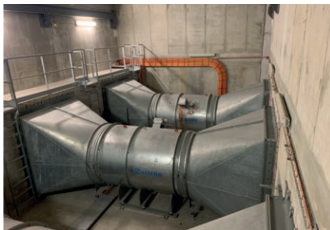
Illustration 7 : Usine de ventilation (crédit photo : CETU)
