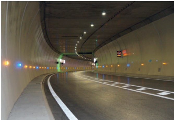
Illustration 4 : Plots de balisage lumineux orange et bleu installés sur les piédroits (crédit photo : CETU)
