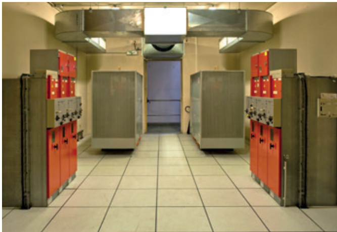
Illustration 9 : Équipements de transformation et de distribution de l'énergie électrique (crédit photo : Laurent Mignaux / Terra)
