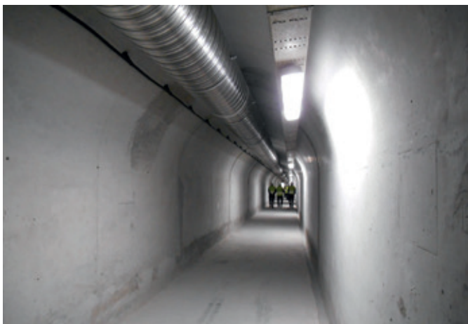
Illustration 5 : Éclairage d'une galerie d'évacuation (crédit photo : CETU)
