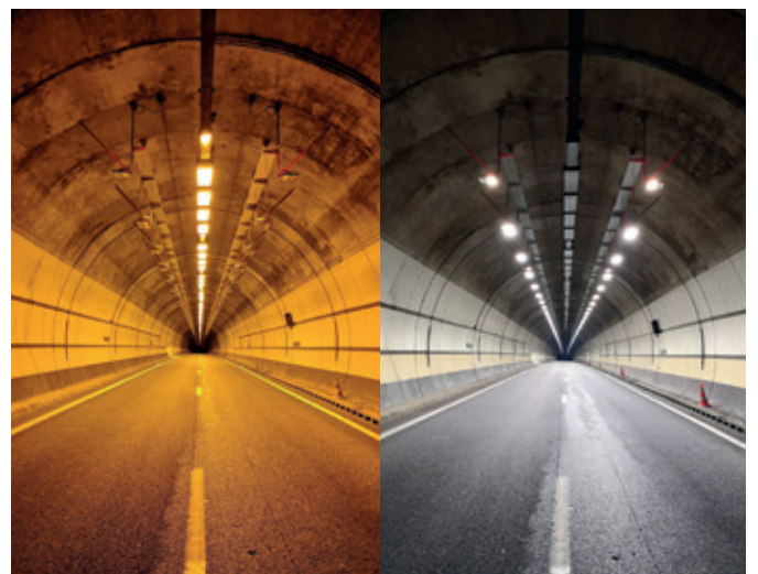
Illustration 15 : Renouvellement de l'éclairage de la tranchée couverte de Noailles À gauche : avant renouvellement, luminaires sodium basse pression À droite : après renouvellement, luminaires LED (crédit photo : CETU)
