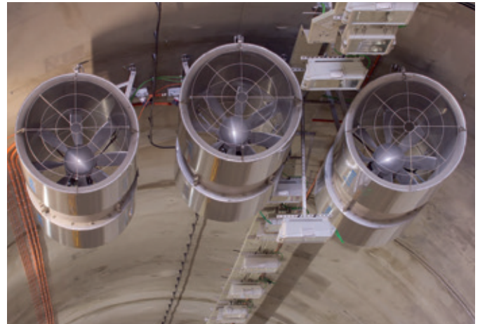
Illustration 2 : Accélérateurs et luminaires en voûte (crédit photo : CETU)
