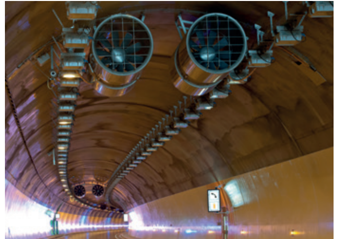
Illustration 20 : Batterie d'accélérateurs (crédit photo : Laurent Mignaux / Terra)
