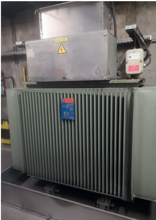
Illustration 23 : Transformateur (crédit photo : CETU)
