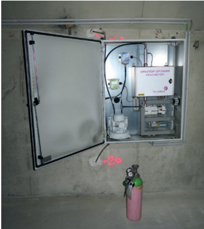
Illustration 19 : Bouteille de gaz titré afin de vérifier les performances des capteurs de pollution (crédit photo : CETU)
