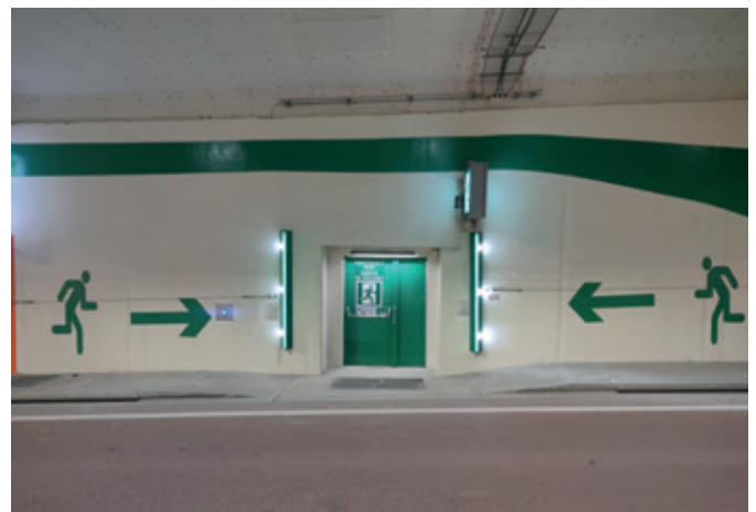
Illustration 6 : Éclairage de la porte d'une issue de secours (crédit photo : CETU)
