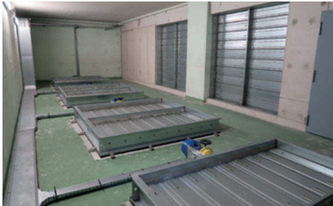
Illustration 22 : Trappe dans un plénum de ventilation (crédit photo : CETU)
