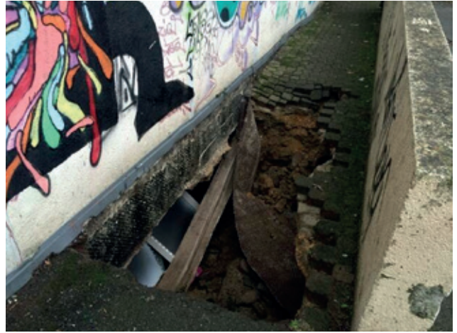
Photographie du fontis apparu dans le magasin Noz. Celui-ci a une surface d'environ 20 m 2 et 3 m de profondeur. Trois personnes sont tombés dans ce fontis, mais ont pu s'en extraire sans gravité. © Journal Ouest-France du 19/11/2016. Référence : fiche tunnelier AFTES GT4 n°126, TES n°274.
