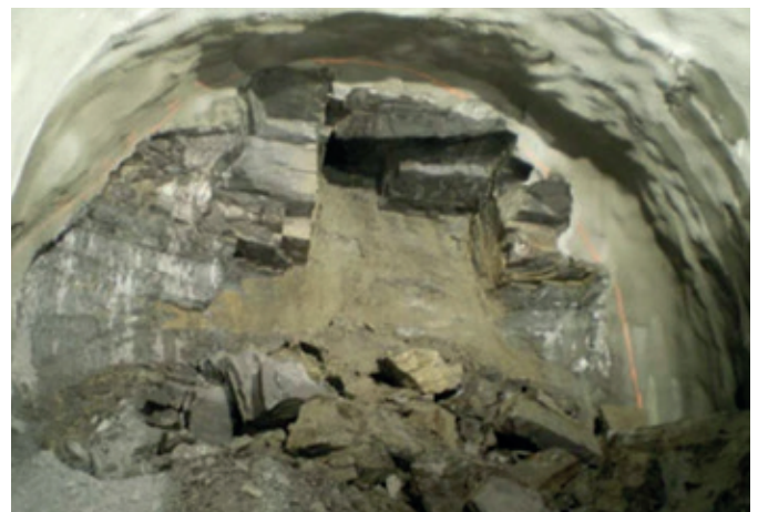
Illustration 4 : Exemple d'instabilité en massif rocheux dans le tunnel de Chavannes (France, 70).
