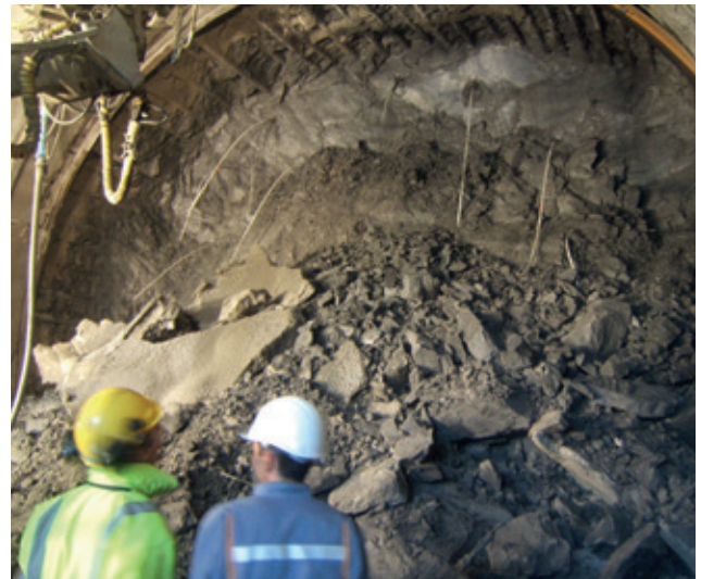
Vue du front après un des effondrements. Les boulons de front ainsi que la voûte parapluie sont clairement visibles. © Nicolas Dupriez, DDE 25.
